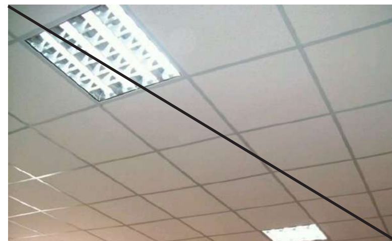
Плохо Открытые направляющие
